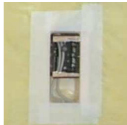
コンセントボックスカバーの耳と防湿フィルムを気密テープで処理
