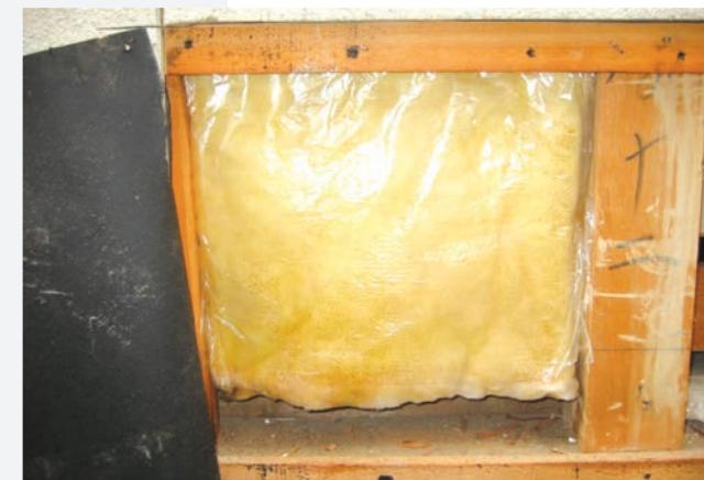
西壁を剥がしグラスウールの状況を確認する ▶ 26年経過しているが状態は良く、結露の痕跡はなかった
