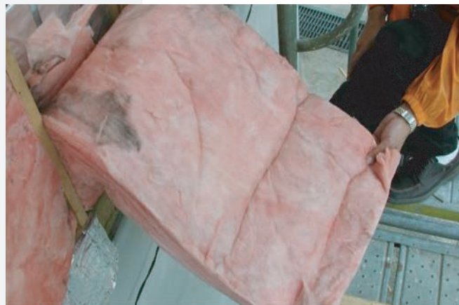
北面浴室側のサッシ枠下部に雨がしみ込んだ形跡有り ▶ 内部のグラスウールには性能劣化がみられない
