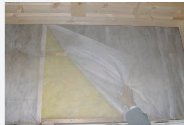
黒ずんだ透湿防水シートを切り開いてグラスウールの状態を見る ▶ グラスウールは驚くほどきれいな状態
