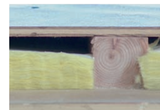
床と合板の間に隙間ができている
