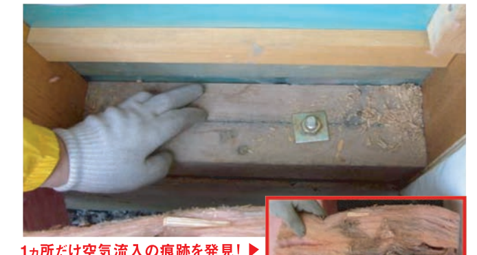
1ヵ所だけ空気流入の痕跡を発見! ▶ グラスウールの下端の変色があったが土台には影響なく、性能を劣化させるほどの傷ではなかった
