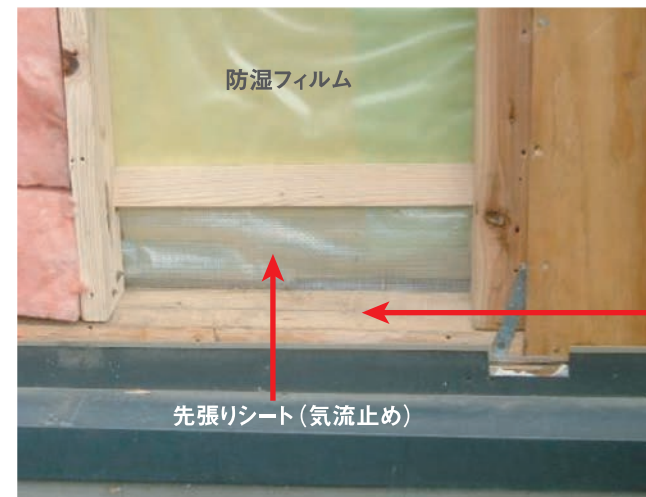
土台付近も乾燥しており、結露の形跡は微塵もなし
