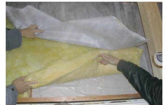
グラスウールをめくり防湿フィルム側もチェック ▶ カビの発生は見られず、結露の形跡もない
