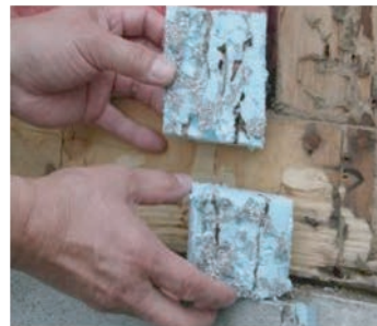
断面を剥がしてみると、蟻道がはっきり確認できた
