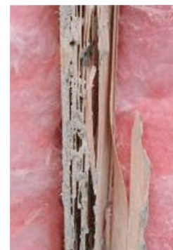
シロアリの被害でスカスカになった柱
