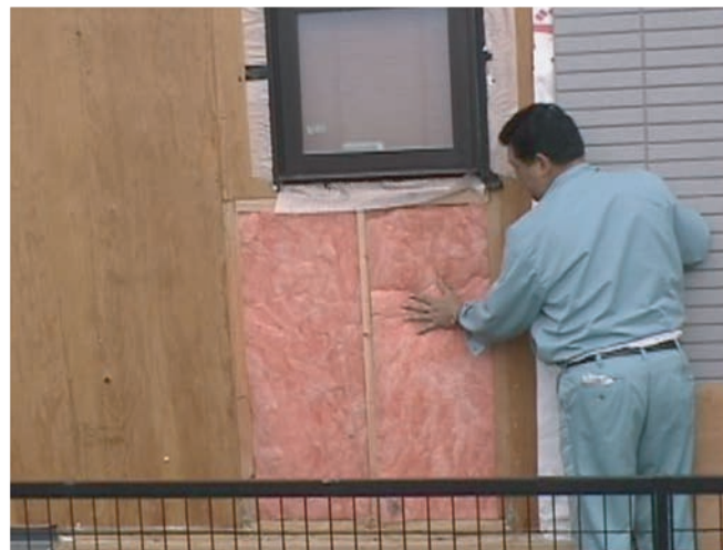
窓下のグラスウールを検証 ▶ 完璧な乾燥状態で、弾力も充分
